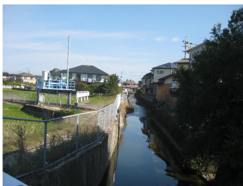
写 5-3 飯倉 6-23 付近の水門
